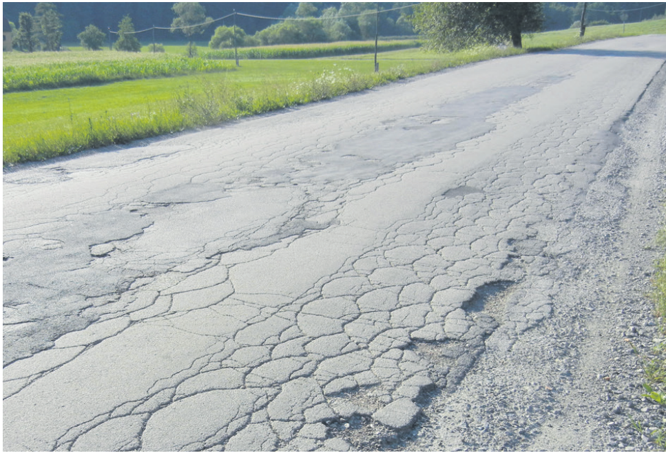
Na območju občine Polzela je zelo potrebna obnove tudi državna cesta med Polzelo in Velenjem, ki jo ministrstvo za infrastrukturo obnavlja postopoma.
