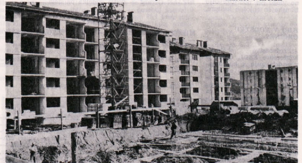
Stanovanjski bloki v Zrečah 7, 8 in 9 v različnih fazah izgradnje, za blok 10 pa pripravljajo temelje
