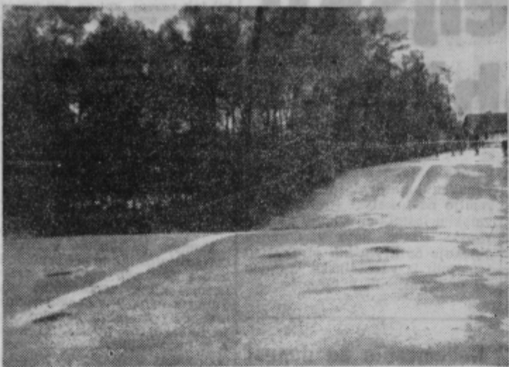
Najprej se je pogreznil del mosta
