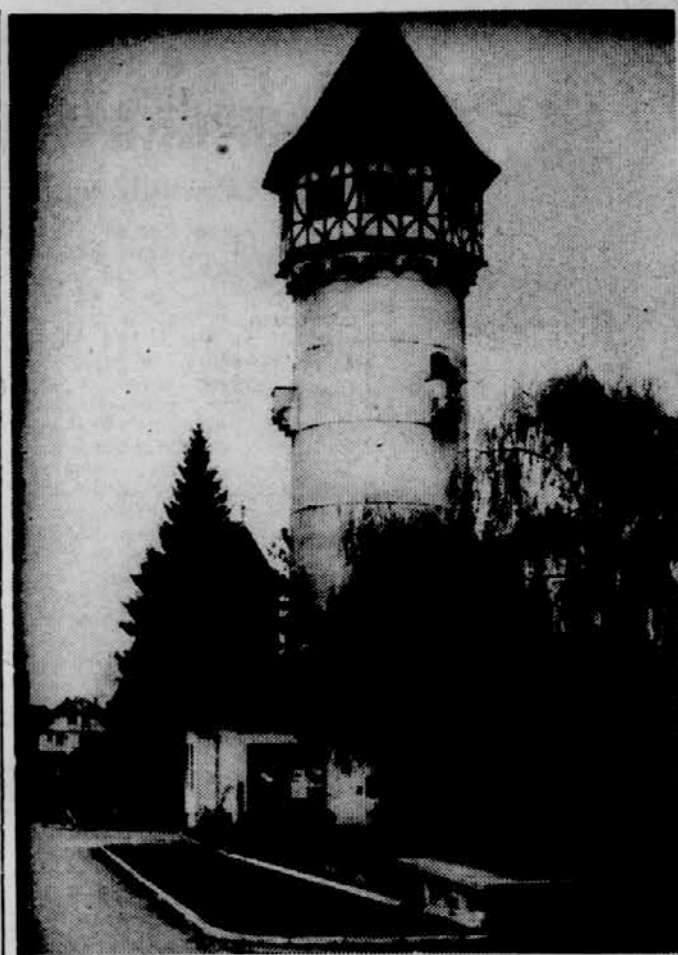
VODOVODNI STOLP V BREŽICAH NI TAKO TRDEN KOT KAZE NA ZUNAJ — Precej razpok ima in pravi, da bi ga lahko porušili že najmanjši potres. Za obnovo celotnega vodovodnega omrežja bo morala občinska skupščina v prihodnje nameniti precejšnje zneske. Foto: Jožica Teppey
