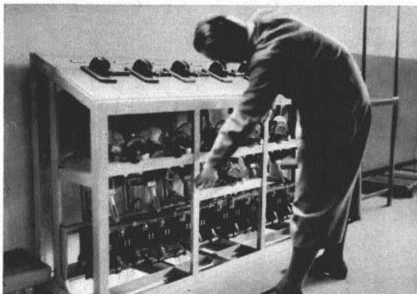
Schaltkabel für Heizung und Kühlwasser der Senderöhren
