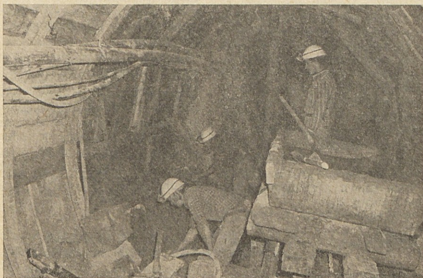
Na sedmem obzoru jame Hrastnik je bila proga po talni glini poskusno obzidana s sidri in torkretiranim betonom. To permanizacijo sedaj odstranjujejo, ker ni vzdržala pritiskov in jo zamenjujejo z betonskimi kvadri.
