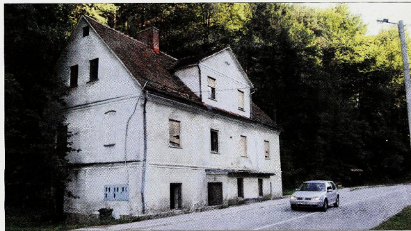
Stavba, nekoč dom številnim družinam, klavno propada ob cesti med Kasazami in Libojani.
