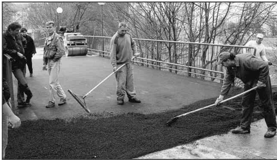
Marjan Salobir je zmagovalec na zadnjih državnoborskih volitvah predlagal, da dokažejo, da obnova Kardeljevega trga ni bila le predvolilna obljuba. In že ob koncu tedna so gradbeni stroji zabmeli na nadvozu med pošto in trgom
