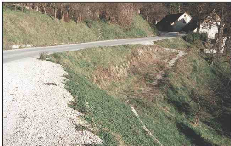
Lani je mestni proračun zagotovil polovico potrebnih sredstev za sanacijo plazov ob križišču za Spodnje in Zgornje Kavče, ki je edina cestna povezava z Velenjem. Letos naj bi dela nadaljevali v zimskem času, a se krajanje bojijo, da bo plaz spet začel drseti. Sploh, če deževje ne bo prenehalo.
