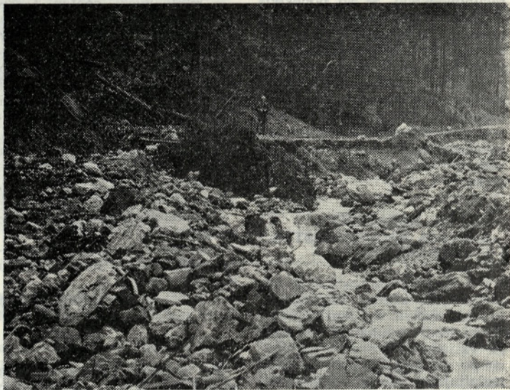
Porušeni in odplavljeni odsek gozdne ceste v Vobnici (foto GG Kranj)
