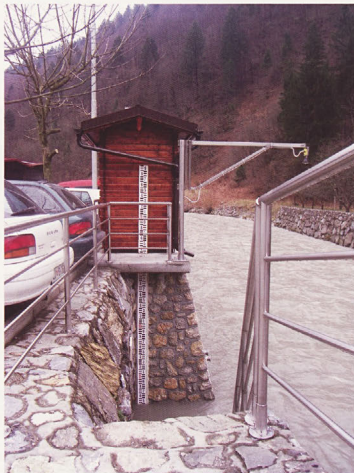
nova avtomatska vodna merilna postaja ob našem parkirišču
