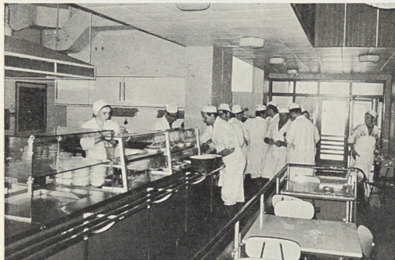
Tudi v obratu za družbeno prehrano imajo kotle (kar šest po približno 250 litrov) na paro. Seveda pa jim pri delu pomagata tudi elektrika in plin.
