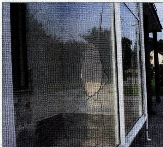
Razbita steklena vitrina na gasilskem domu na Jag-njenici.
