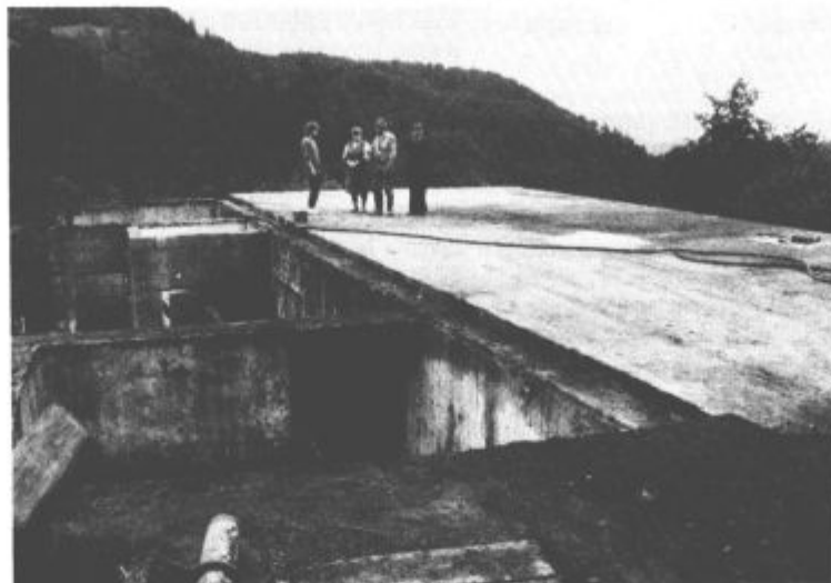
Še to kar je ostalo od gospodarskega poslopja bo treba verjetno zrušiti, saj je pustil ožen na betonski plošči in zldovju svoje sledi.
