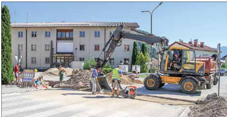
Širjenje sistema daljinskega ogrevanja poteka med starim občinskim objektom, preko Savinjske ceste in naprej mimo zdravstvenega doma na Praprotnikovo ulico.
