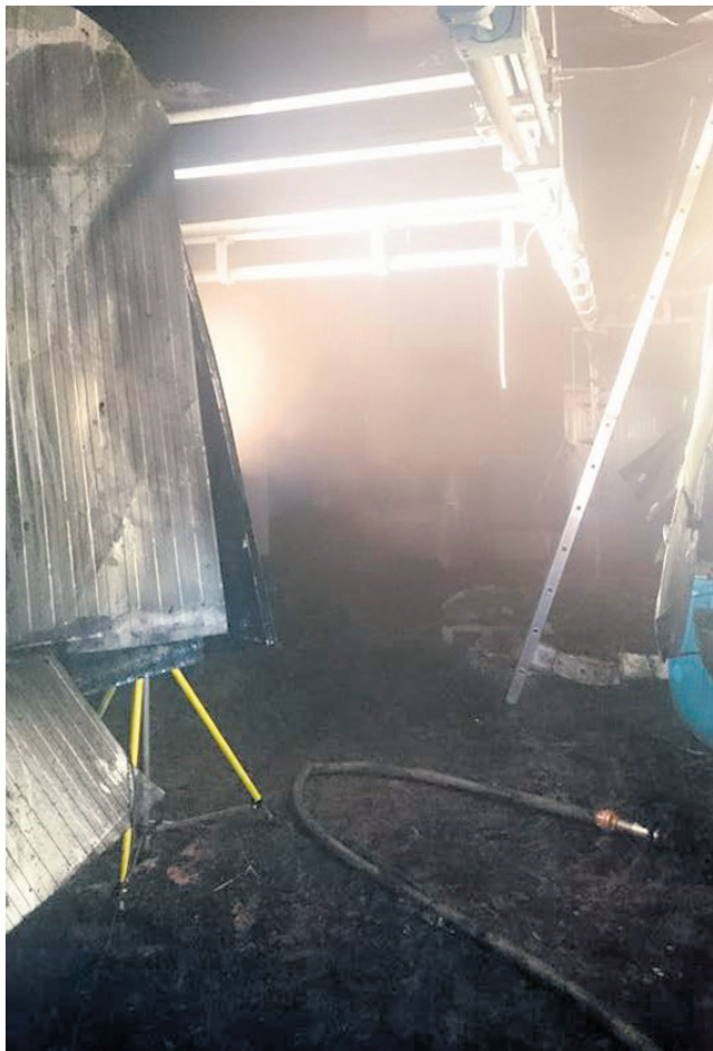
Notranjost stavbe je uničena.
