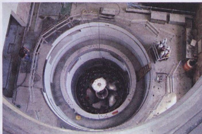
Pogled v srce hidroelektrarne.
