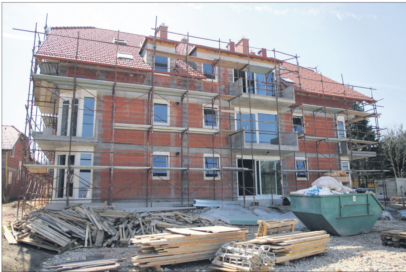
V Nepremičninah Celje so pred dnevi pridobili uporabno dovoljenje za novozgrajeni blok na Teharjah. V njem je 21 neprofitnih stanovanj – šest garsonjer, dve enosobni, osem dvosobnih in pet dvoinsobnih stanovanj – ki bodo vseljiva v začetku oktobra.
