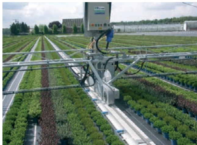
» Kotalno e-verigo lahko uporabite pri dolgih hodih namakalnih sistemov. Cevi in kabli so varno vodeni.
