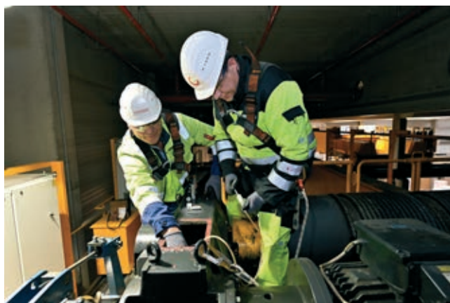
» Podroben pregled notranjosti zobniškega prenosa dvigala. S tem ko podjetje Konecranes izvede analizo olja, lahko odkrije sledi obrabe, kot so rja ali kovinski delci v olju zobniškega prenosa, kar preprečuje neplanirane ustavitve dvigal. | Vir: Konecranes
