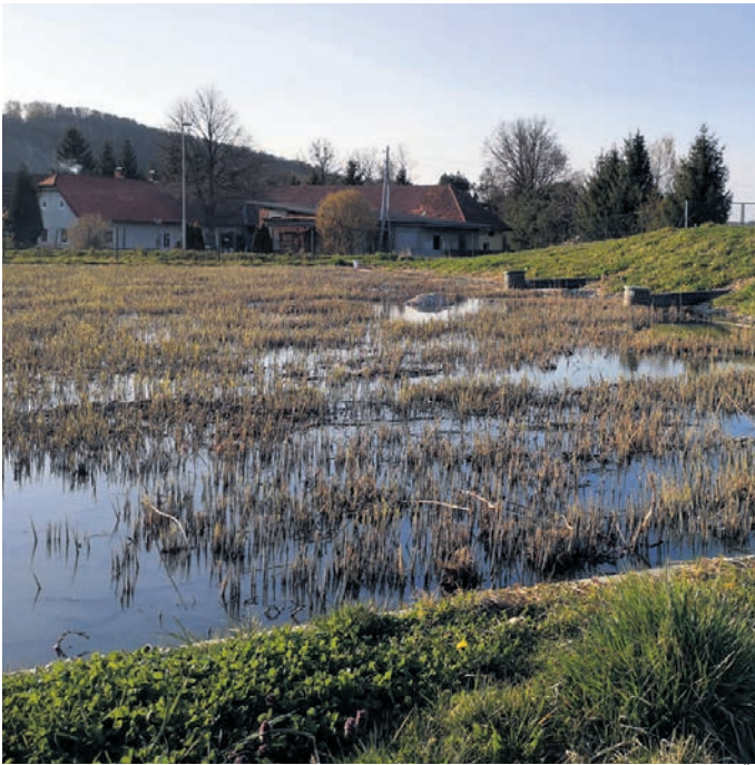
Zaradi zastajanja odpadne vode na prvi gredi rastlinske čistilne naprave v Sodincih se smrad še vedno širi po okolici. Na občini že pripravljajo rešitev.
