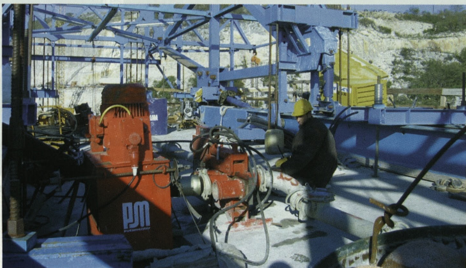
Slika 18 • Hidravlične naprave betonovoda
