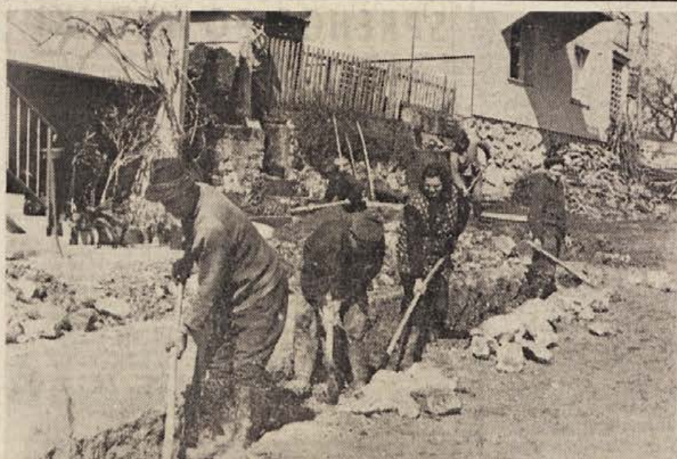
KS Otočec polaga te dni vodovod čez Krko. Dolenja vas na desnem bregu Krke bo s tem dobila vodo. K temu so pripomogli prebivalci s prostovoljnimi deli in prispevki ter KS Otočec in podjetje Vodovod. Če bo šlo vse po sreči, bodo v Dolenji vasi za prvomajske praznike že imeli vodo. Vsega bodo položili več kot 400 m cevi. Na sliki: prebivalci kopljejo jarek na otoški strani. (Foto: M. Jakopec)
