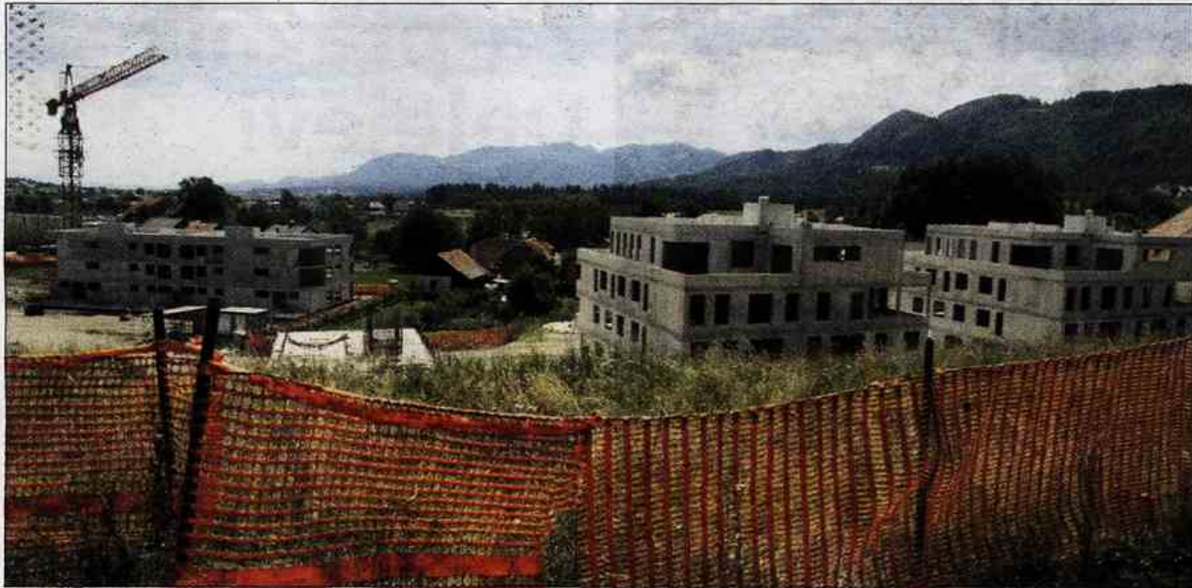
Gradbinec (in hkrati investitor) je odšel in za seboj pustil nedokončane objekte. Z njimi je ogrozil življenje prebivalcev v Brodeh nad gradbiščem.
