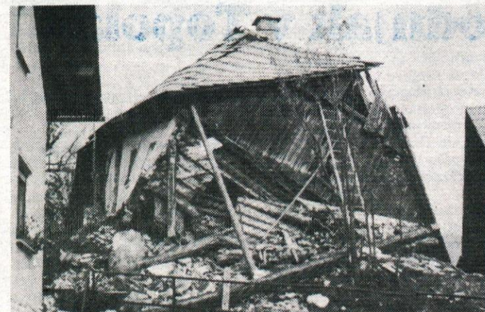
Stara hiša na Vrankah ni mogla kljubovati plaz, ki je bil posledica velikega deževja... podrla se je...
