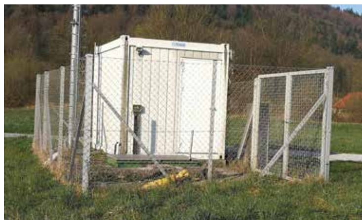
Kanalizacijsko črpališče Tomišelj 1
