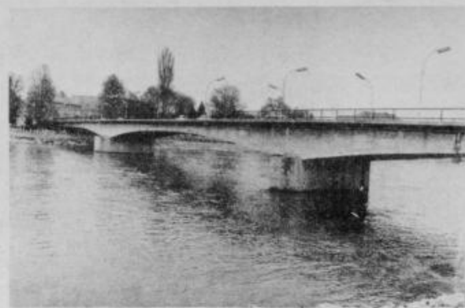
Vozišče na mostu v Ptuj je potrebno temeljitega popravila
