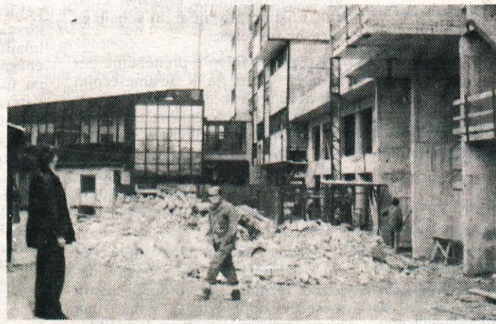
Zaključek gradnje objekta SPB-1 se imenuje lamela F - 1. Tu vam prinašamo nekaj pogledov na to gradnjo...
