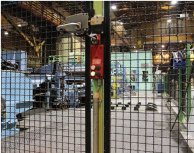
» Varnostna ključavnica na vratih zaščitne ograje. | Vir: Unitechnik Automatisierungs
