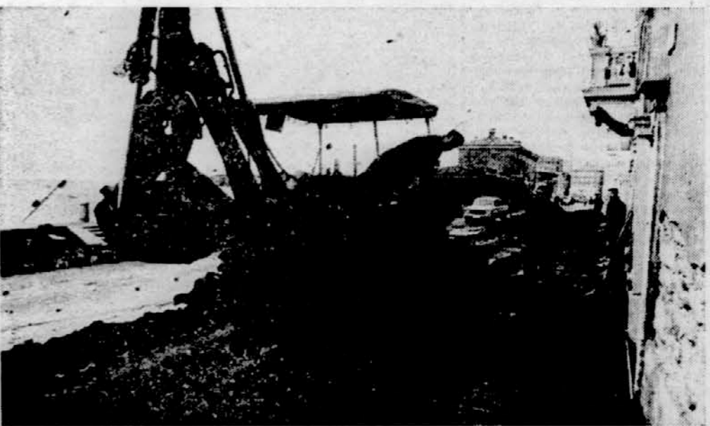
CIMPREJ POPRAVITI SKODO — Cesto med Portorožem in Piranom je morje na mnogih mestih izpodjedlo, tako da ni bila več sposobna za promet. Že zgodaj jutro so začeli odstranjevati skale in kamenje, ki jih je morje vrglo na obalo. Tako so cesto za silo že usposobili. Foto: E. Selhaus
