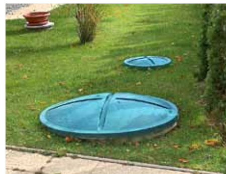
Odpadne vode - Foto (vir): Delo in dom: Z gradnjo malih komunalnih čistilnih naprav trenutno še ni treba hiteti.
