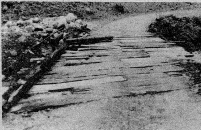
Uničeni mostovi ob potoku Ljubije. Tudi sicer je za graditelje vodovoda ostalo veliko upostojenost na nekaterih mestih ceste, ki bi jo zaradi neuporabnih mostov morali pregledati odgovorni organi za promet.
