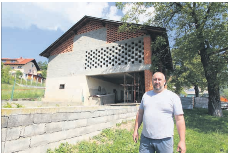
Domačini v Brodeh iz dneva v dan preštevajo nove razpoke na objektih. Gospodarsko poslopje Roberta Mešiča je plaz tako poškodoval, da zadrževanje v njem in njegovi okolici ni več varno. Objekt je predviden za rušenje.
