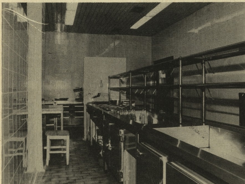
Kuhinjski prostori v novi menzi novozgrajenega samskega doma v Šuštarjevi koloniji v Trbovljah (foto: B. Klančar)
