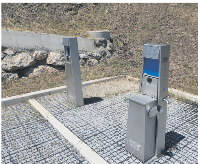
Tako je videti stebriček, s katerim avtodom priklopimo na elektriko in vodo. Ta dva sta popolnoma nova na Šmohorju.
