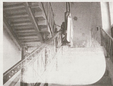
Na stopnišču vgrajeno dvigalo za invalide
