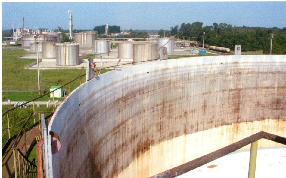
Rezervoarji v skladišču goriv v Lendavi
