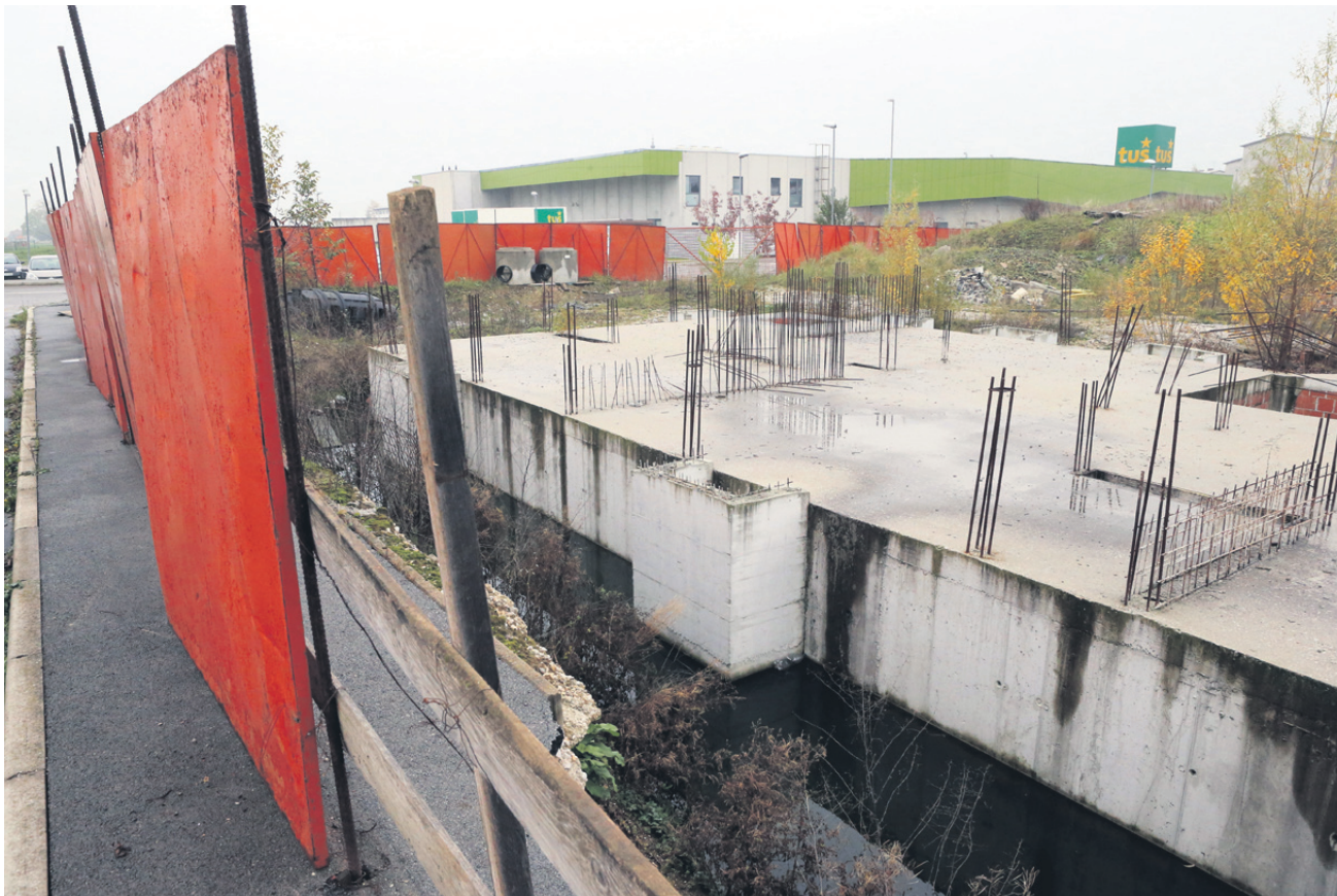
Veter je podrl dotrajano ograjo. Na gradbišče tako lahko iz radovednosti zavijejo tudi šolarji.
