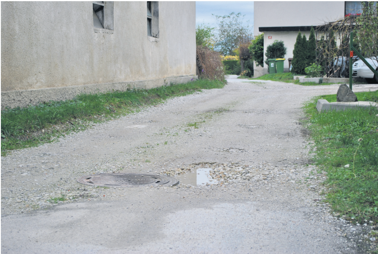
Takole izgleda dovozna cesta v lasti KS Gotovlje, ki naj bi bila po nekaterih zapisih asfaltirana. Za ureditev 30 metrov dovozne ceste, ki jo uporabljajo stanovalci treh stanovanjskih hiš (ena je nenaseljena), se trudijo že dolgih dvajset let. V tem času so sami in na lastne stroške večkrat obnovili nastale poškodbe in zasuli večje luknje. Delna popravila so občasno naročili tudi lastniki (KS Gotovlje), a so bila po mnenju lastnikov parcel precej neučinkovita, saj je bilo vozišče po vsakem deževju v še slabšem stanju, pravijo.
