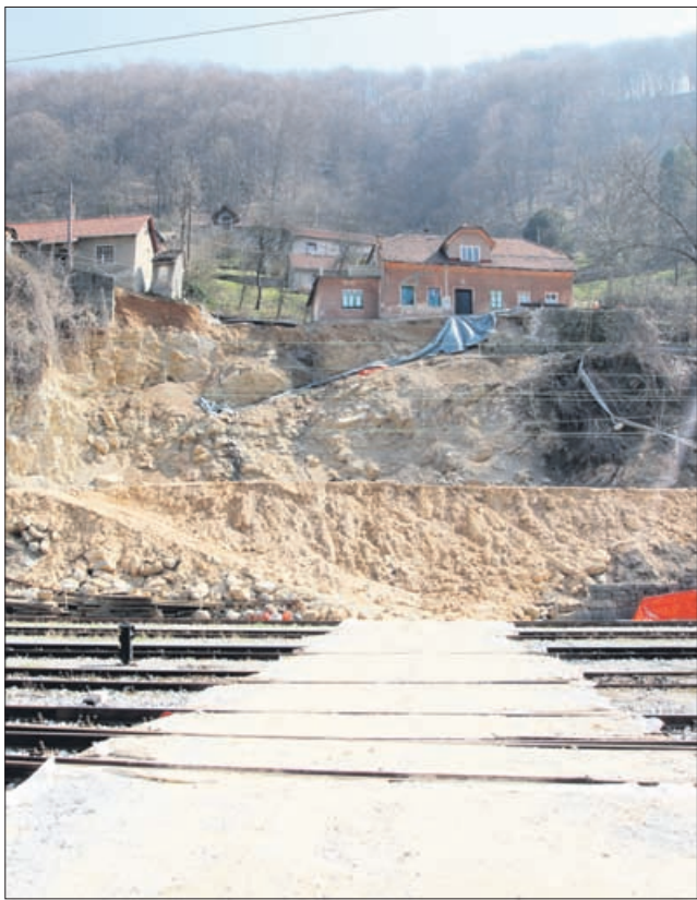
Sanacija plazu Majland bo poleg ureditve ceste zajemala tudi železniški prehod oziroma podvoz. Dve hiši, ki stojita ob plazu, nameravajo podreti.
