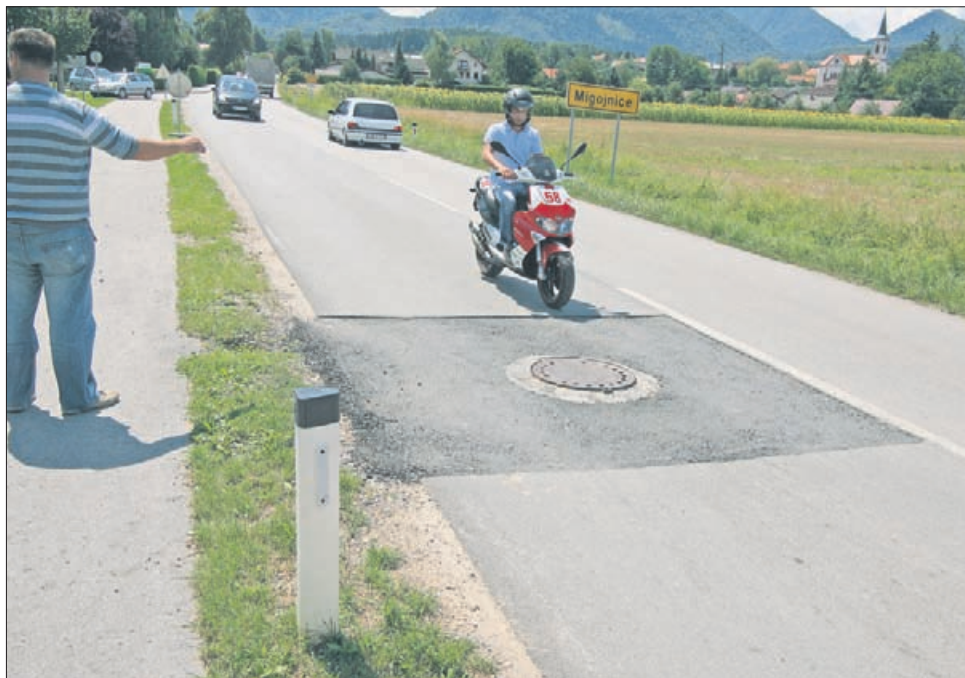
Na cesti Griže-Žalec, kjer obnavljajo vozišče, se lahko nesreča zgodi v vsakem trenutku. Vozniki se z vjuganjem izogibajo jaškom na cesti in samo vprašanje je, kdaj bo počilo. Policisti so zato še kako pozorni na ta odsek.
