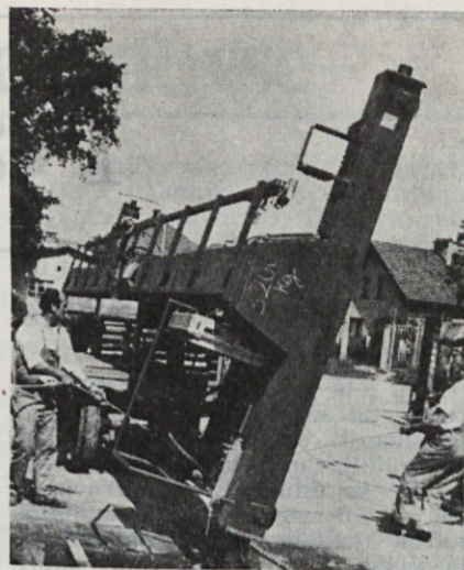
Transport mostnega dvigala
