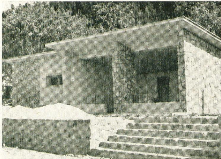
Trgovsko podjetje Ljubelj gradi moderen trgovski paviljon v Pristavi, v katerem bodo sodobni trgovski lokali. — Tako bo tudi Pristava končno dobila prepotrebno trgovino
