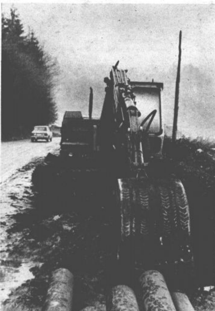
Delavci in stroji Nivoja iz Celja so pričeli urejati nov industrijski vodovod iz Topolšice do termoelektrarne Šoštanj.
