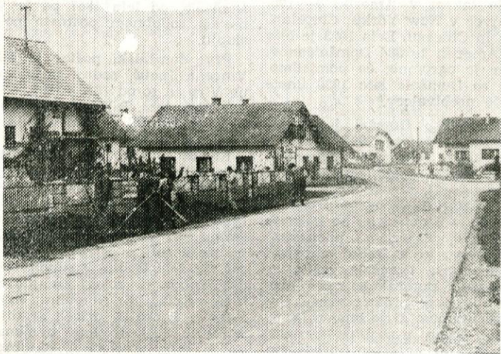
Tudi Bukovčevo cesto na Viru že urejajo. Sedaj polagajo rob- nike, nato pa bodo uredili in asfaltirali pločnike in s tem za- varovali pešce pred vedno gostejšim prometom
