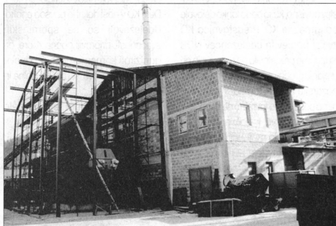
Nov kotel bo omogočil manjše stroške obratovanja in bistveno višji izkoristek (foto: Ciril M. Sem)
