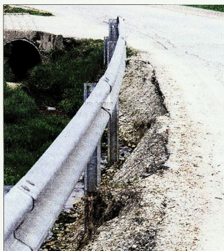
Bankina ob cesti se nevarno udara.
