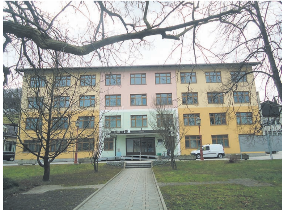
»Preden so bile opravljene zadnje meritve, smo pridobili predračune za morebitno obnovo. Ker gre za sanacijo celotne zgradbe od strehe do temeljev, se finančno to najverjetneje ne bi splačalo. Stavba je stara 60 let, poravnati pa se je ne da. Po dosedanjih ugotovitvah bi jo lahko le ucvrstili, da se v naslednjih letih ne bi še bolj nagibala,« pojasnjuje Stanko Šket.
