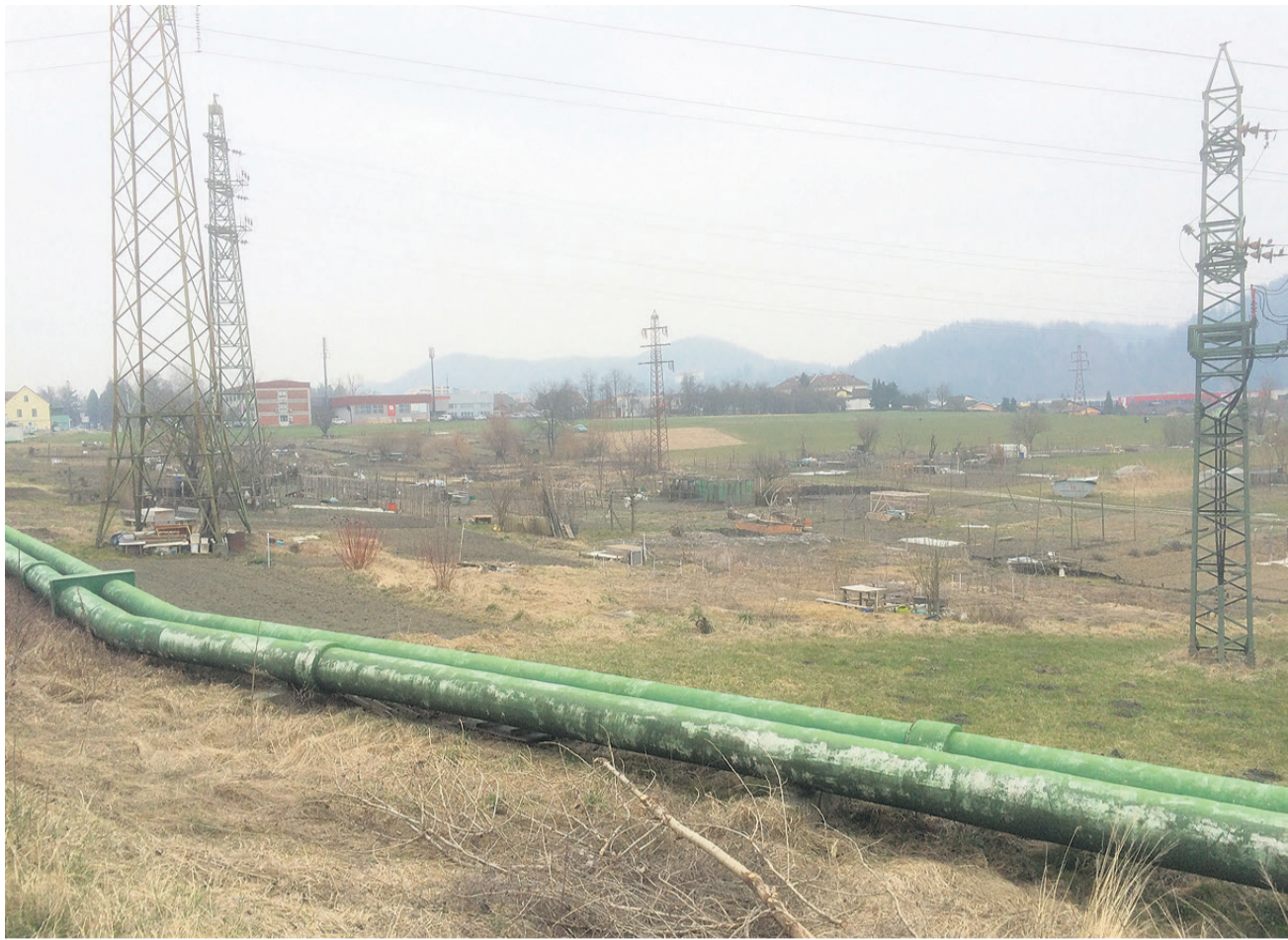
Zaradi tehničnih težav v Tešu na praznični ponedeljek sistem daljinskega ogrevanja ni ogrel domov Velenjčanom in Šoštanjčanom.
