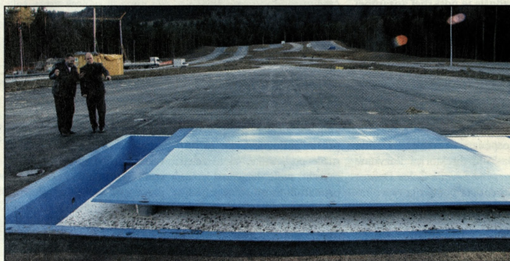
Drsna plošča, vgrajena v cestišče, kjer bo mogoče spoznavati različne kritične situacije in manevre v vožnji, predvsem zavijanje in zaviranje na mokri in suhi podlagi.
