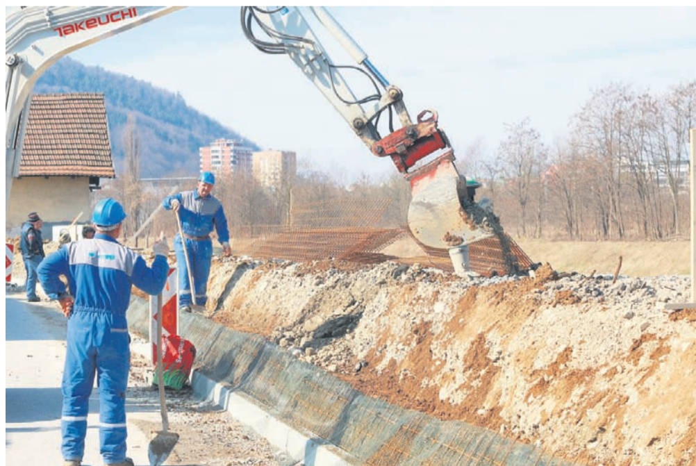
Čeprav sta ministrstvo in cinkarna dala navodila o primerni zaščiti na gradbišču, so delavci opremljeni z osnovno zaščitno opremo. Naše družbe na delovišču ob Voglajni razumljivo niso bili veseli.
