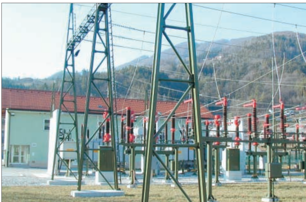
Sodobno 110 kV stikališče naj bi v prihodnje odjemalcem zagotovilo še zanesljivejšo in bolj kakovostno oskrbo z električno energijo.
