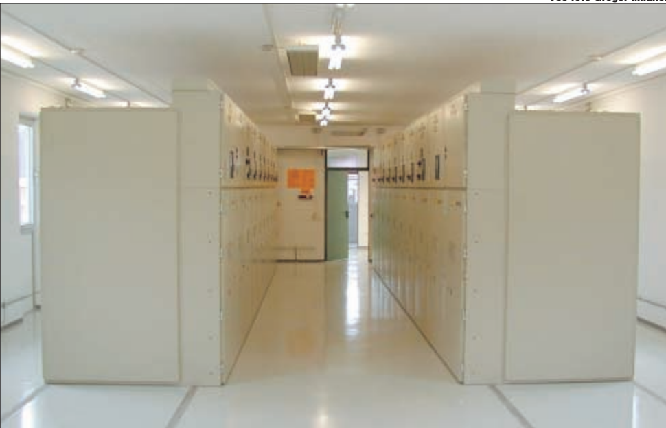
Pogled na 20 kV stikališče.
