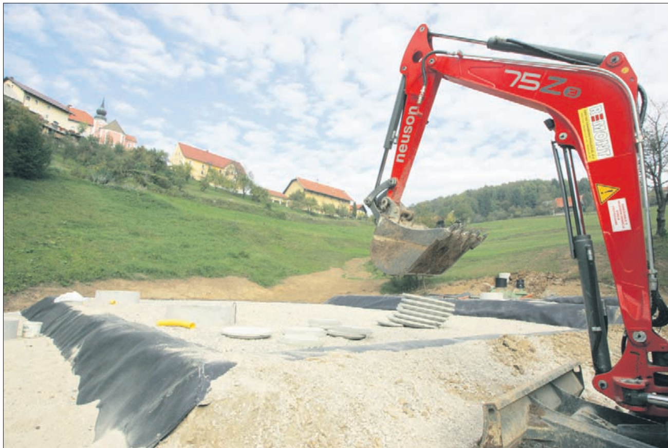
Po zasaditvi vegetacije bo rastlinska čistilna naprava dejansko neopazna.
