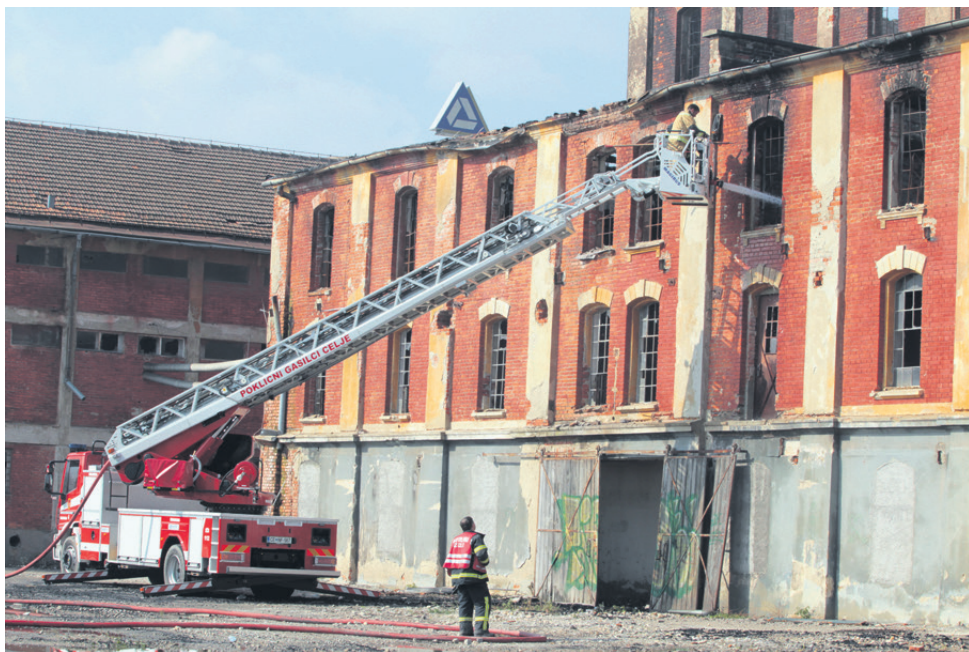
Po požaru je stavba nevarna.
