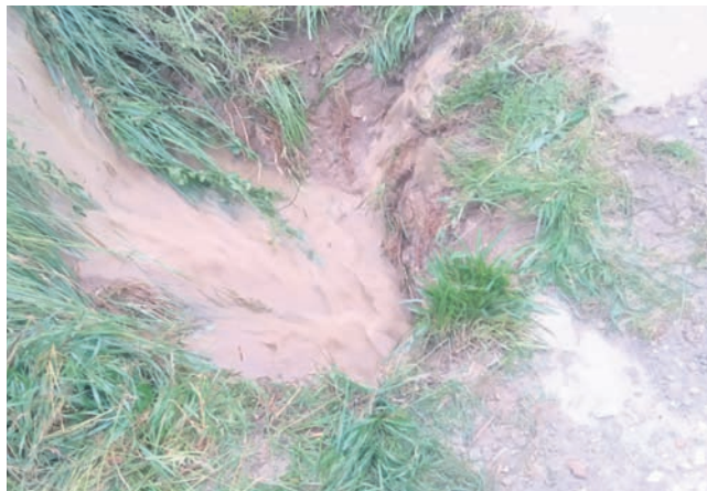
Vhod v jašek, kamor je deroča voda potegnila nesrečnega dečka.
